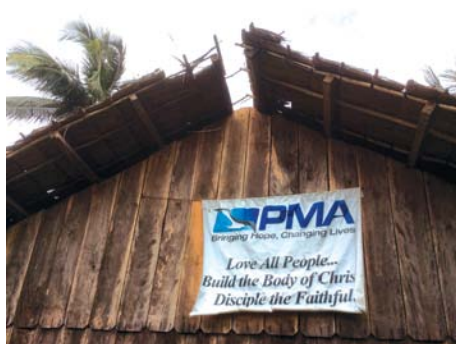
PMA Amaga – zerstörtes Dach des Versammlungsgebäudes
