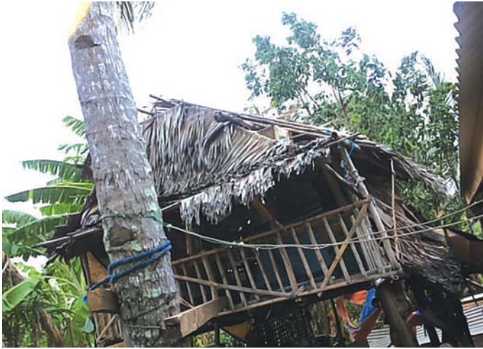
Das Gästehaus der PMA Amaga wurde vom Taifun zerstört
